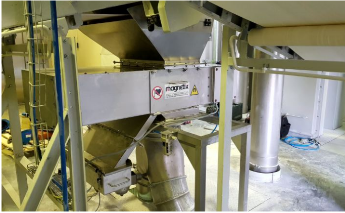
Beseitigung von Eisenverunreinigungen aus Zucker. Einbau im Zuckerschacht.
