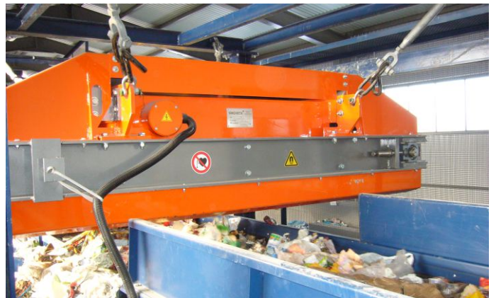
Rückgewinnung von Alteisen aus kommunalen Abfällen.
